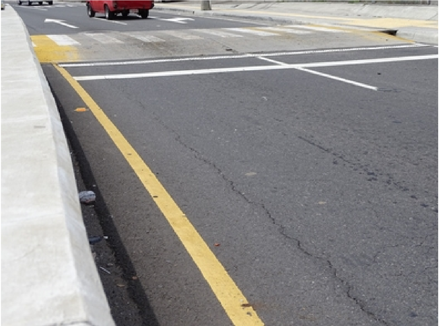
A simple vista se pueden apreciar las grietas presentes en el asfalto de las vías del Paso a Desnivel en Guadalupe. Foto LanammeUCR.
