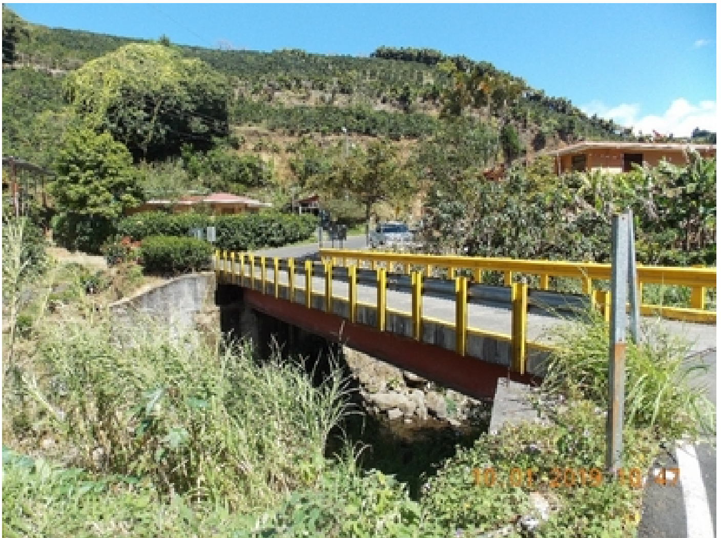
Inspección en el puente Calle Toro, del río Trojas en Sarchí. Foto cortesía LanammeUCR.
