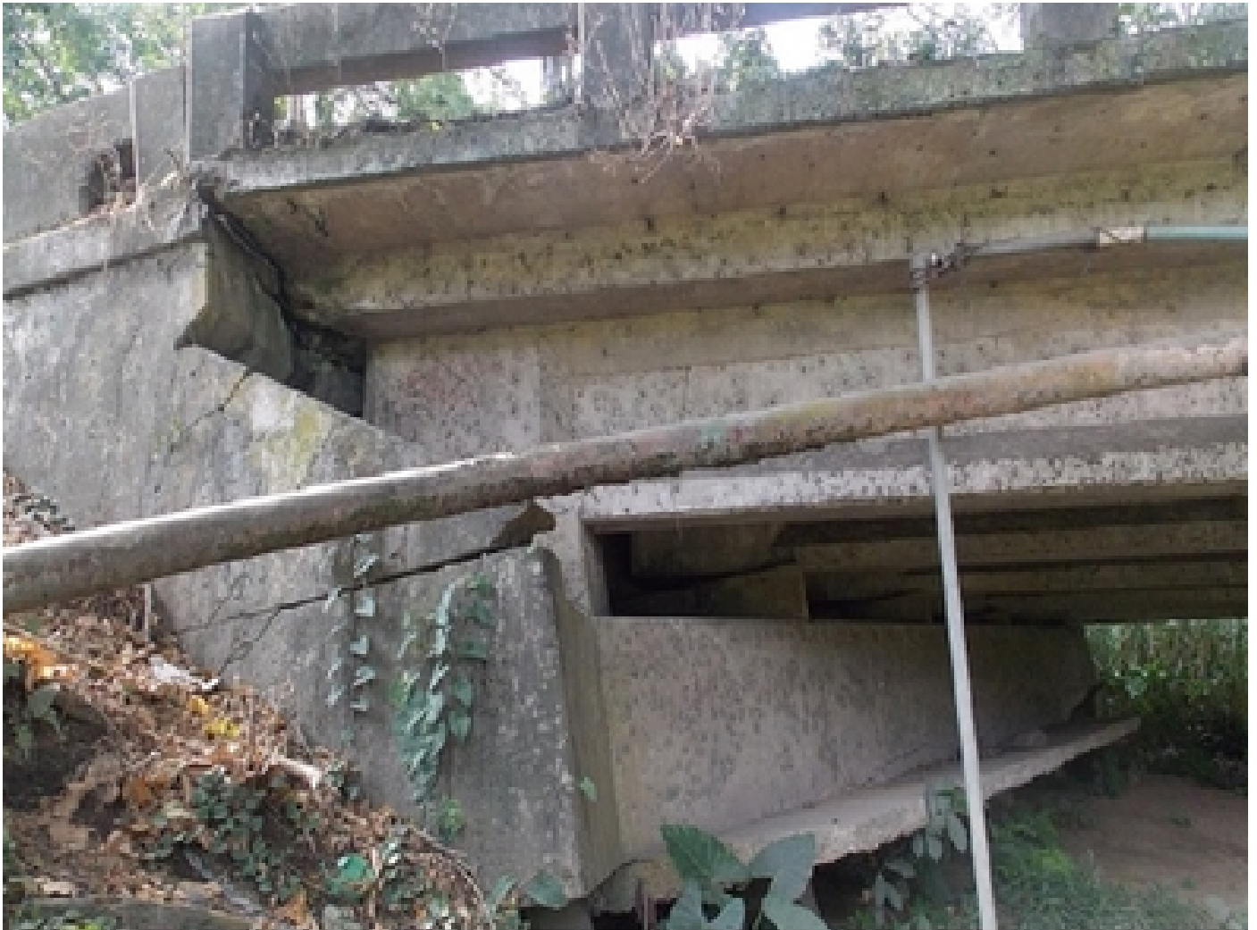
Estructura del puente sobre el río Blanco en la ruta nacional 32. Foto cortesía LanammeUCR.
