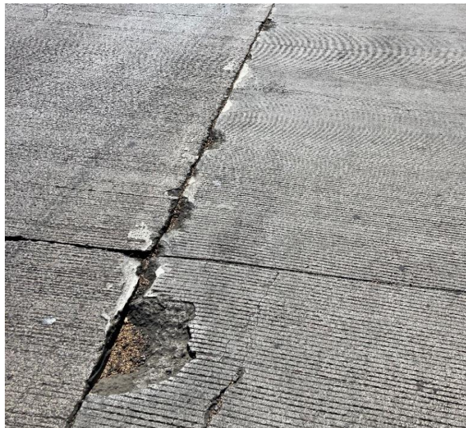
Figura 16 Fracturas de juntas en el est. 0+880 sentido de venida.
