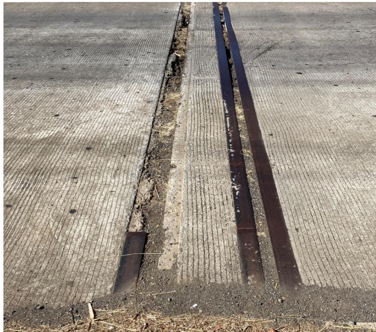
Figura 14 Estado de la junta del puente sobre el río Ciruelas, est. 0+610 sentido de ida.
