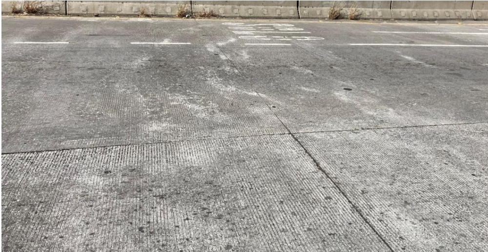
Figura 15 Desprendimiento de agregados en el est. 1+080 sentido de ida.
