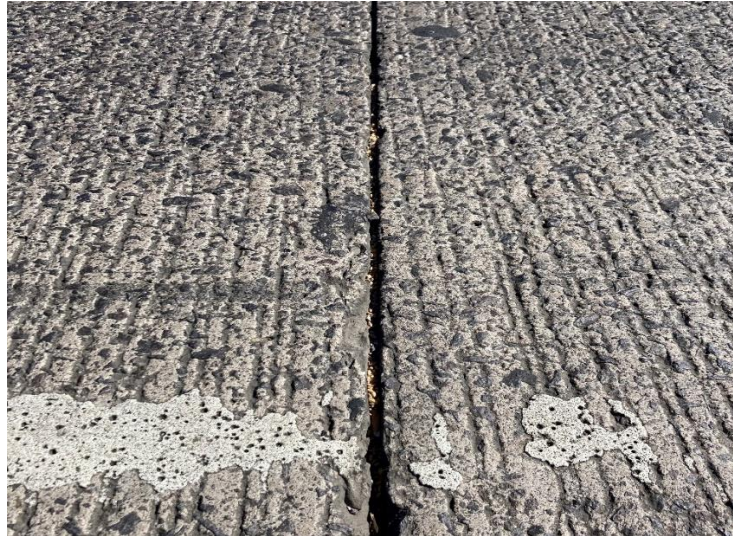
Figura 17 Estado de la junta en el est. 0+980 sentido de venida.
