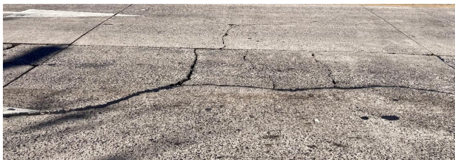
Figura 10 Losa dividida en el est. 0+060 sentido de ida.
