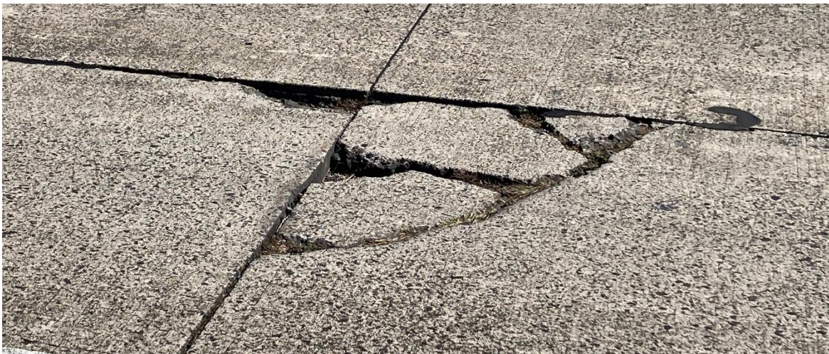
Figura 12 Fractura y agrietamiento en el est. 0+260 sentido de ida.
