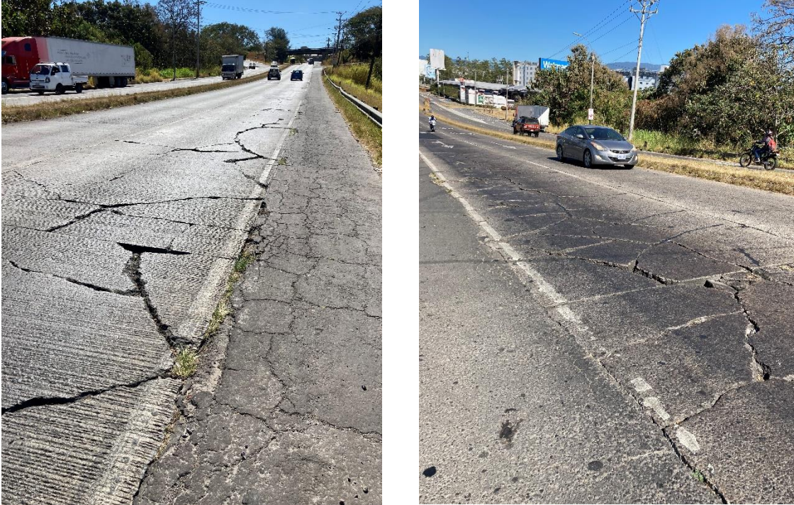
Figura 19 Deterioros severos en las losas del carril externo, est. desde 1+260 hasta el 1+410, sentido de venida.
