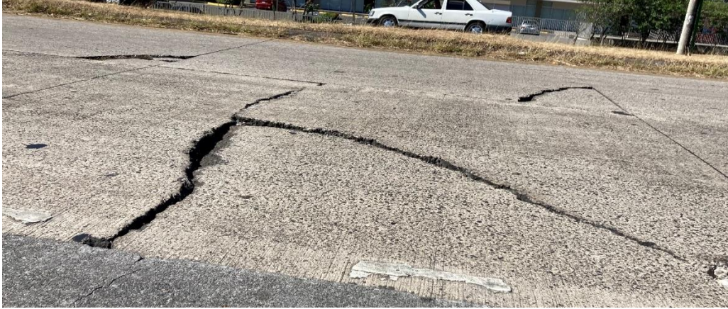
Figura 13 Agrietamiento en el est. 0+350 sentido de ida.
