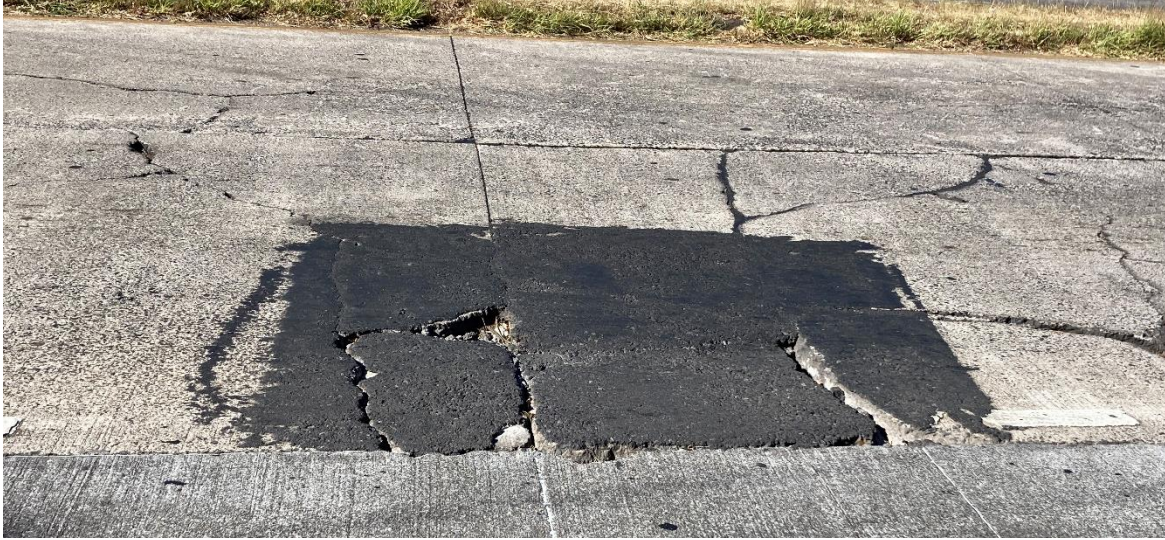
Figura 11 Bache en asfalto en el est. 0+080 sentido de ida.
