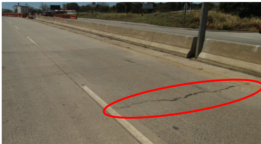
Figura 5. Grieta transversal, estacionamiento 166+400, sentido Cañas - Liberia.
