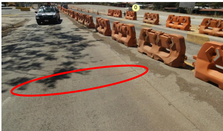
Figura 4. Grieta transversal, estacionamiento 166+315, sentido Cañas – Liberia
