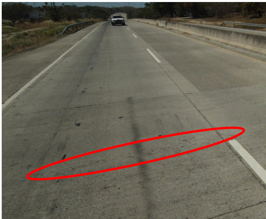
Figura 8. Grieta transversal apenas visible, estacionamiento 205+510, sentido Liberia – Cañas
