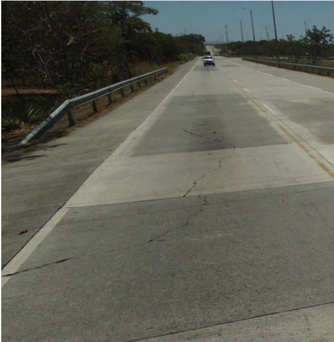
Figura 7. Grieta longitudinal, estacionamiento 186+580, sentido Cañas - Liberia
